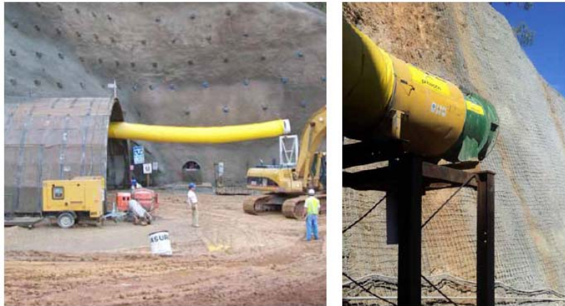
(Fig32.) ventilación que provee aire fresco al túnel
